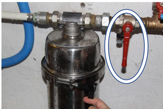
Vanne fermée (perpendiculaire au tuyau)
